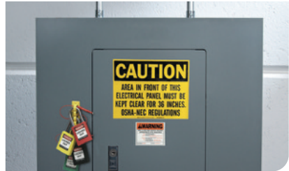
Identificatie van panelen en kasten
